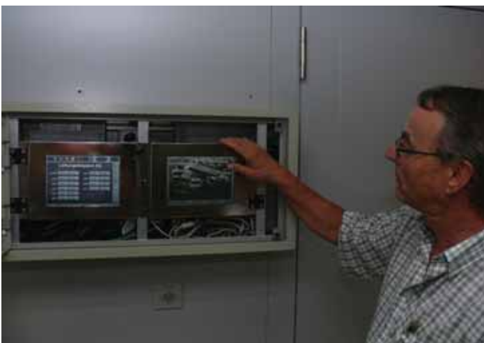
Zentrale Bedienung für Alt- und Neubauten hinter der Türe: Zwei Touchpanels ermöglichen Kontrolle und Bedienung aller wichtigen Funktionen.
