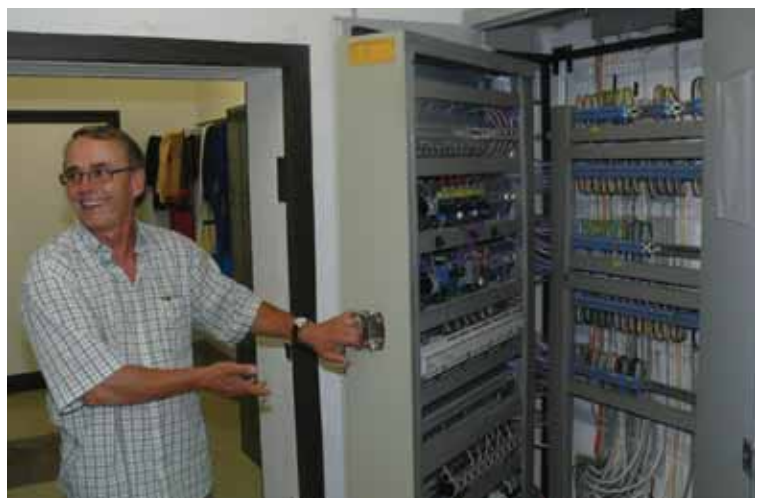
Bis Ende 2008 werden alle alten Sektorenverteilungen durch neue mit Schwenkrahmen ersetzt sein – damit steht eine zweite Ebene für Geräte (z.B. KNX) zur Verfügung und der Zugang zu den Kabeln ist jederzeit gewährleistet.
